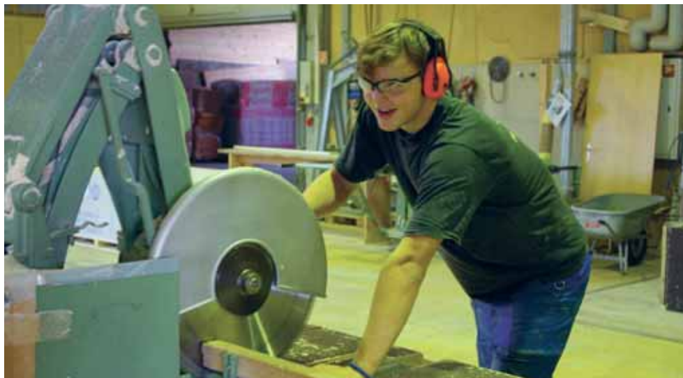
Dominik Kaiser ( 1. Lehrjahr Zimmermann) von der Zimmerei Marxer AG, Mauren, bei den ersten Vorbereitungen für den Standbau.
